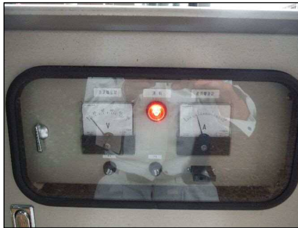
(写-19) 電気防食装置
