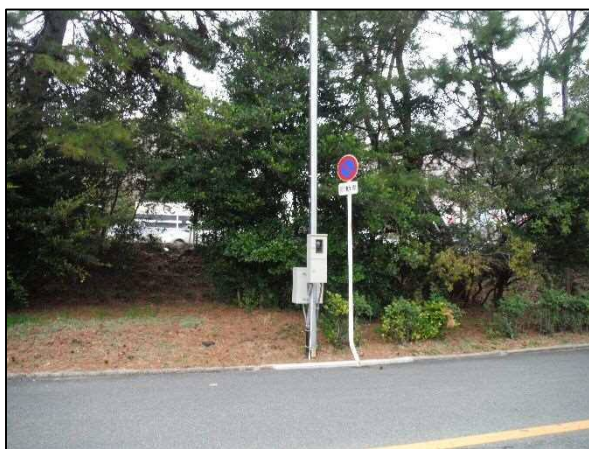
（写-15）電気防食設備
