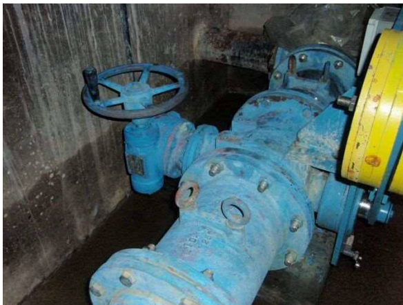
（写-11）飲料水兼用耐震性貯水槽用遮断弁 （島田小学校設置）
