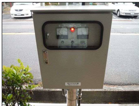
（写-16）電位防食設備
