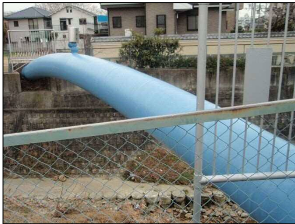
(写-9) パイプビーム
