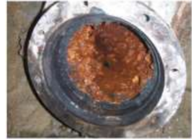
写真：古くなった水道管
