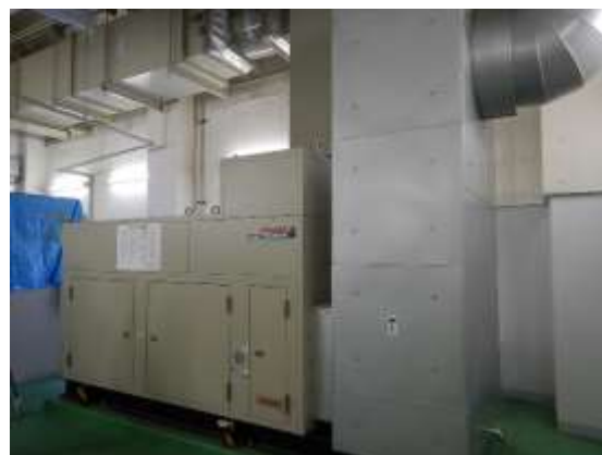
写真：非常用発電設備（柴原浄水場）
