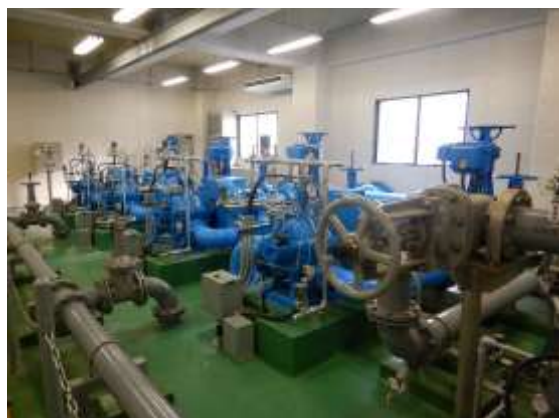
写真：ポンプ設備（柿ノ木受配水場）
