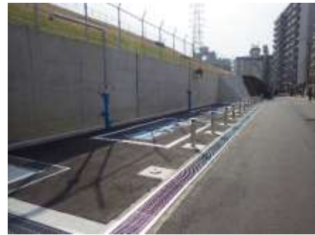
写真：応急給水栓（寺内配水池）
