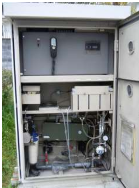
図7. 3 水質モニター内部
