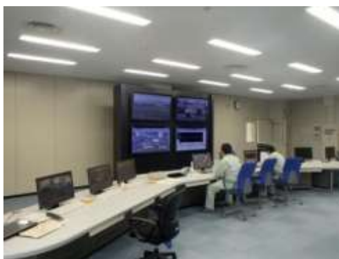
図7. 1 柴原浄水場中央管理室
