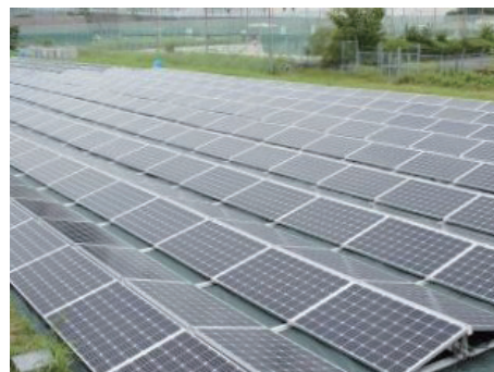
▲ 太陽光発電システム
