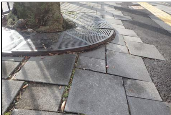
歩道等の舗装の持ち上げ
