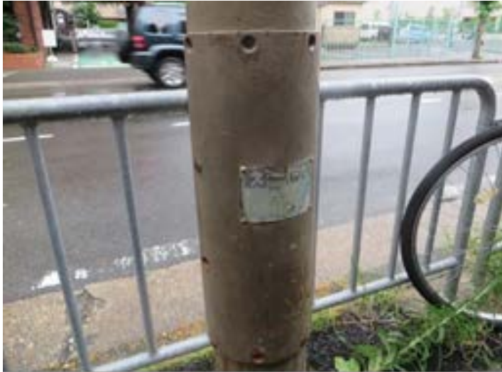
写真 2.5 その他 電気開口部のボルト脱落
