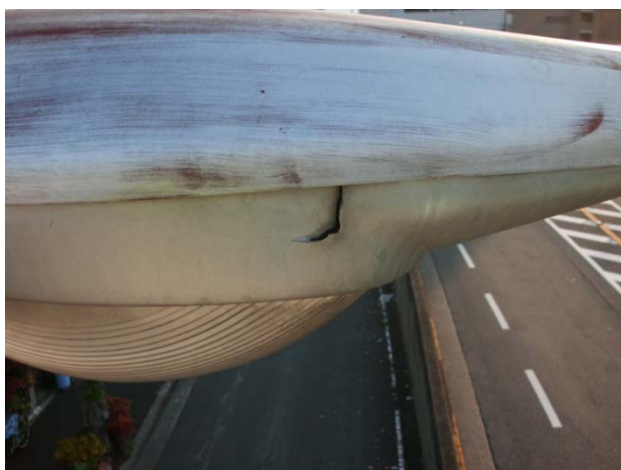
写真 2.2 灯具 亀裂の発生
