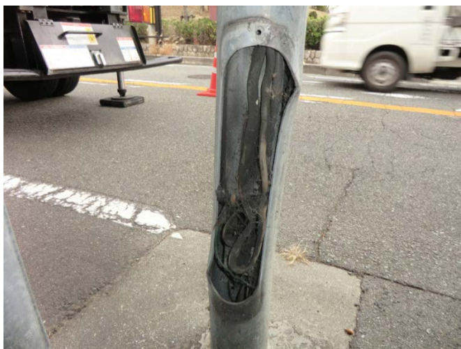
写真 2.1 本体 衝突等による変形
