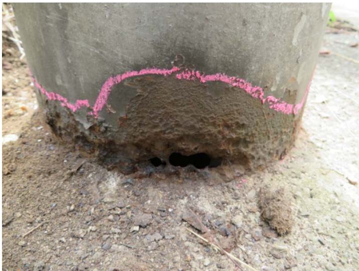
写真 2.4 基礎部の腐食
