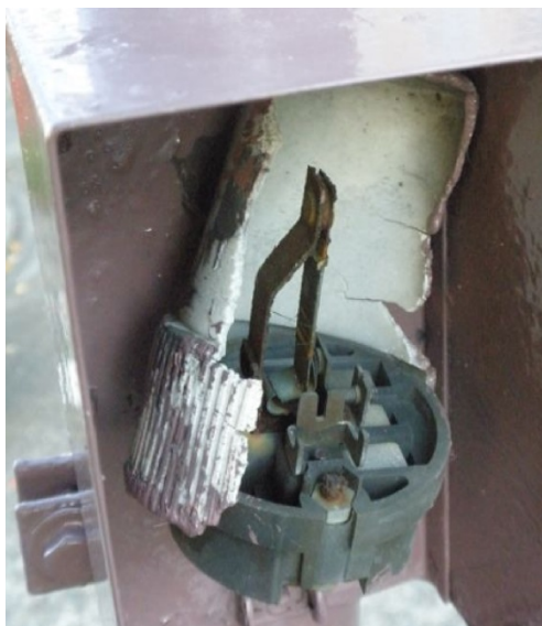
写真 2.6 その他 自動点滅器の損傷
