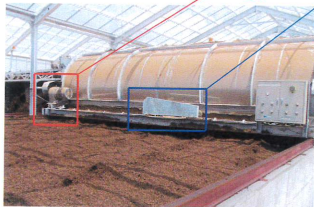
本体投入側（堆肥投入口）
