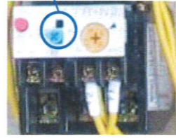
攪拌用マグネットスイッチのサーマルリレー
