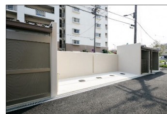
防災マンホールトイレ
