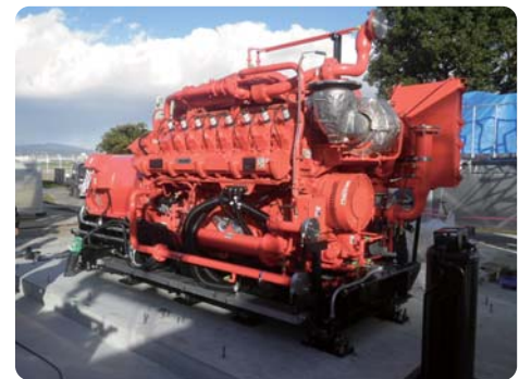
⑥ 消化ガス発電事業
