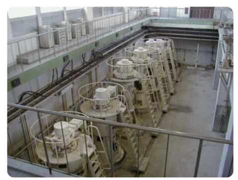
③ ポンプ場
