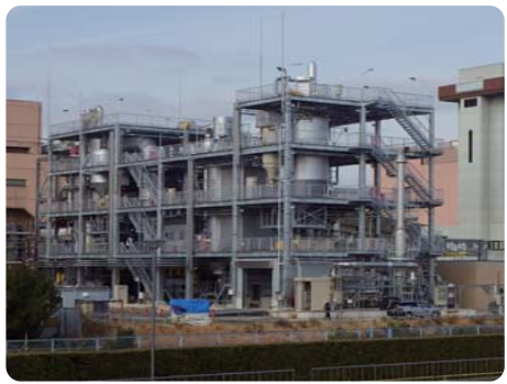
⑨ 汚泥焼却設備
