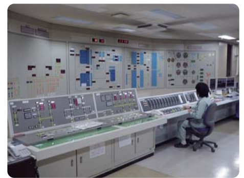
⑤ 中央監視室
